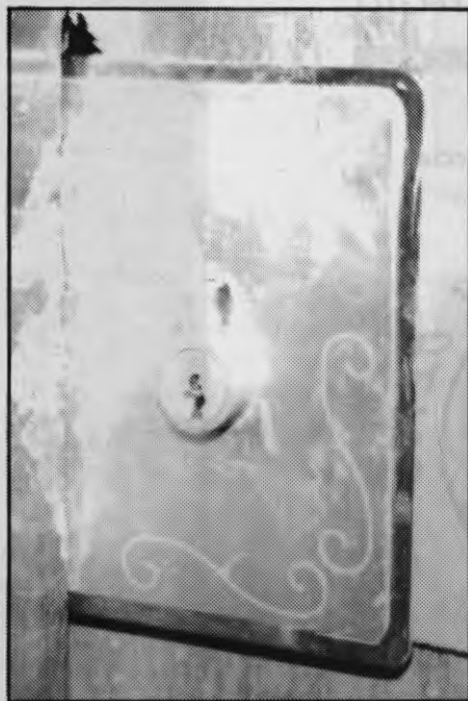
La puerta de la casa de J. M a Losada presenta indicios de forzamiento
