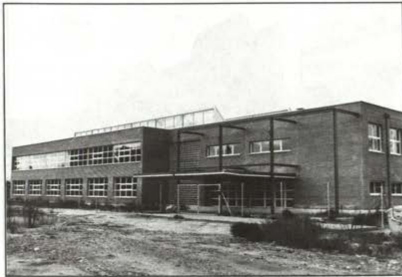
Las ventanas de la Escuela de Hostelería, con los cristales rotos.
