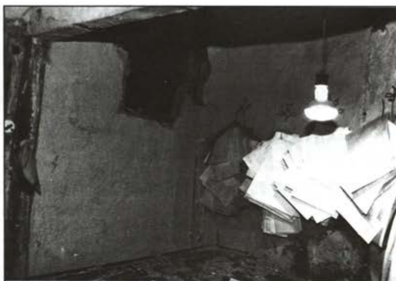
La fotografía muestra el agujero que los ladrones hicieron para pasar desde el portal de la casa contigua a la carnicería.
