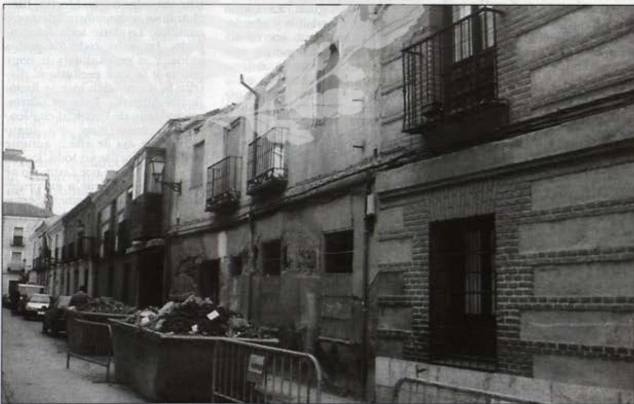
La casa se encontraba en este estado antes de acometer su restauración. Aunque estaba en ruinas, no obstante se aprecia que esta fachada, la original, no tiene nada que ver con la cosa esa que ha resultado de la restauración.
