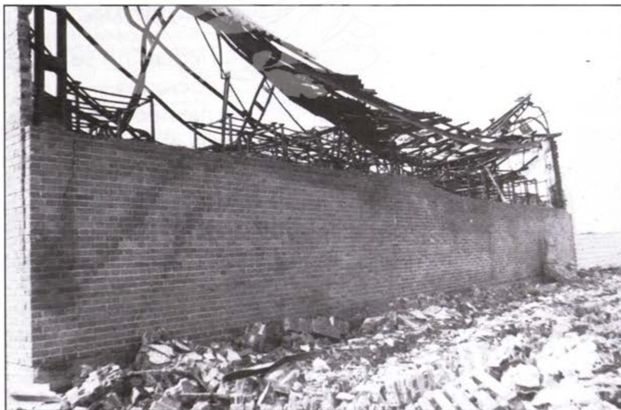
En este estado quedó una de las naves de la empresa.
