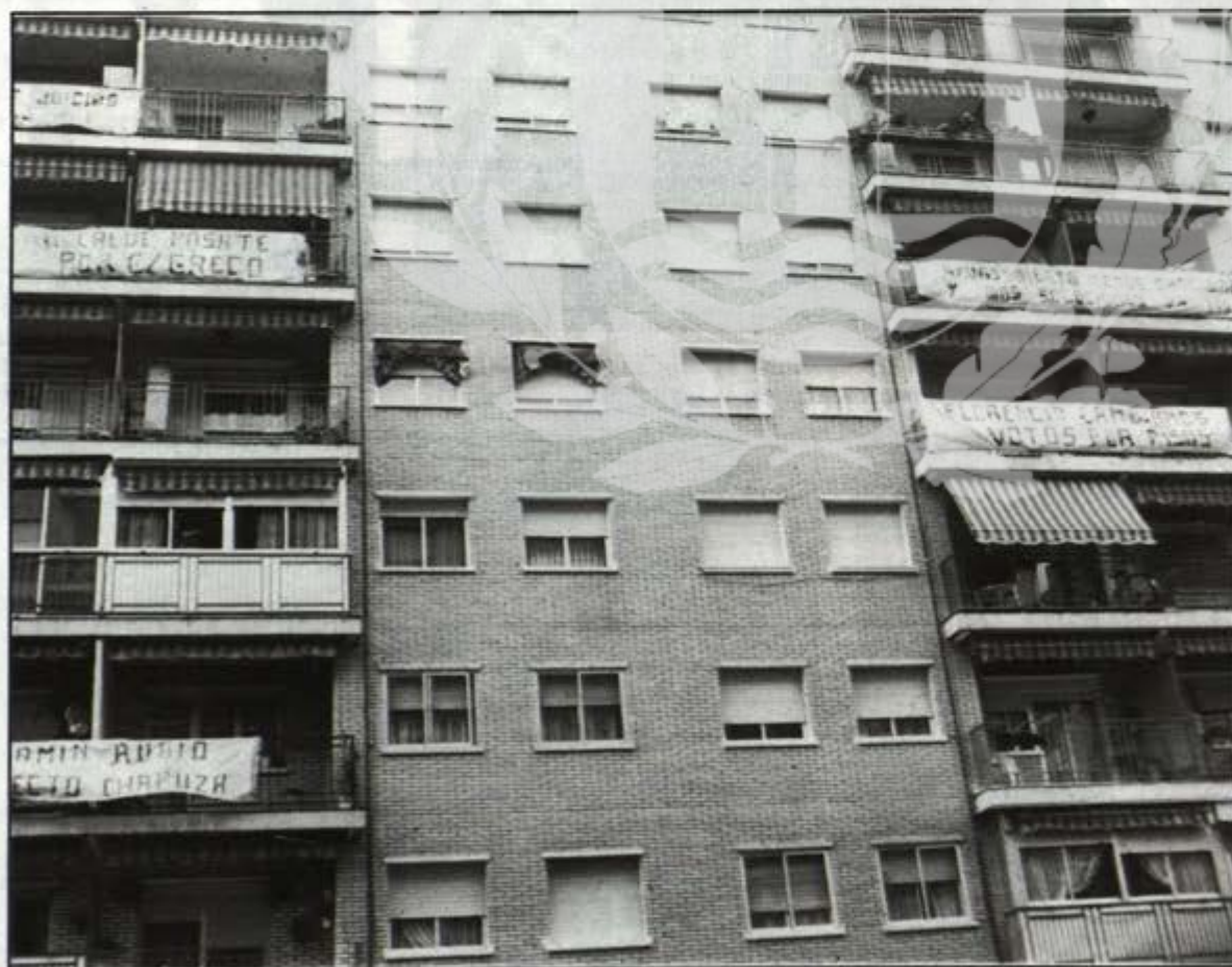
Los vecinos de la calle El Greco «adornaron» así sus viviendas en la primavera del año pasado para llamar públicamente la atención, y también la del ayuntamiento: grietas, goteras, frentes de terraza con riesgos de desprendimiento, ratas en los sótanos llenos de escombros... Los vecinos exigían que el ayuntamiento se implicara en el problema.
