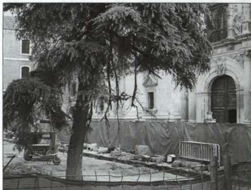
Las ramas de este cedro fueron desgajadas por una excavadora.
