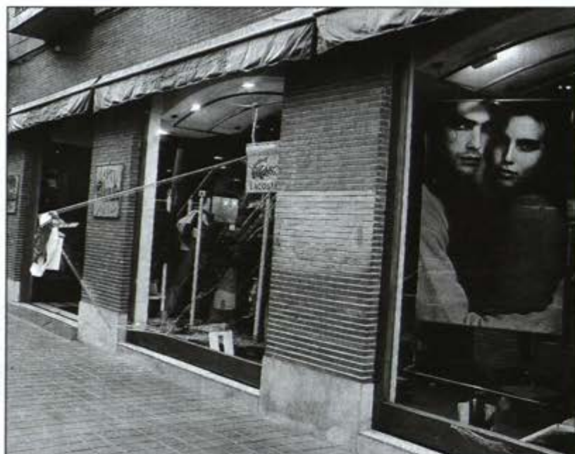
El cristal estaba desmontado y el marco forzado.
