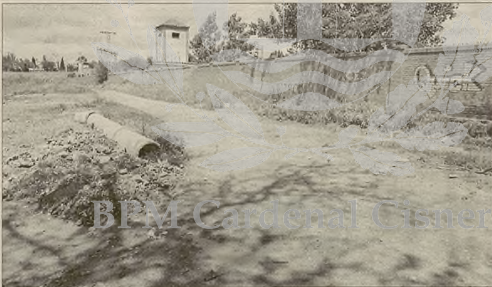
La tubería, que debería discurrir por el subsuelo, ha salido al aire libre sin que nadie se haya dado cuenta / P.O.
