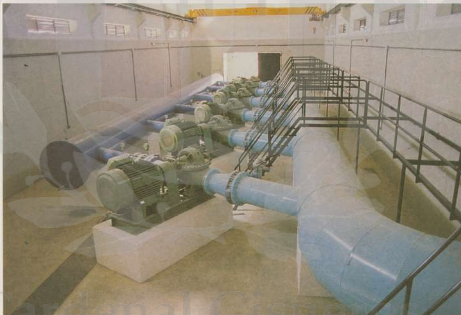
En el futuro, cuando se ponga en funcionamiento el grupo de presurización, el suministro de agua por falta de presión se solucionará definitivamente.
