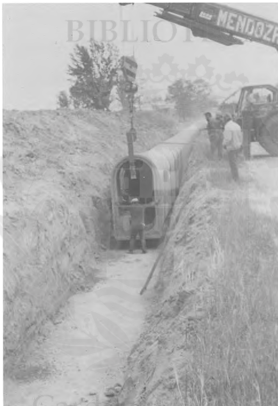
Ochenta y ocho kilómetros tiene la red de colectores de recorrido subterráneo.
