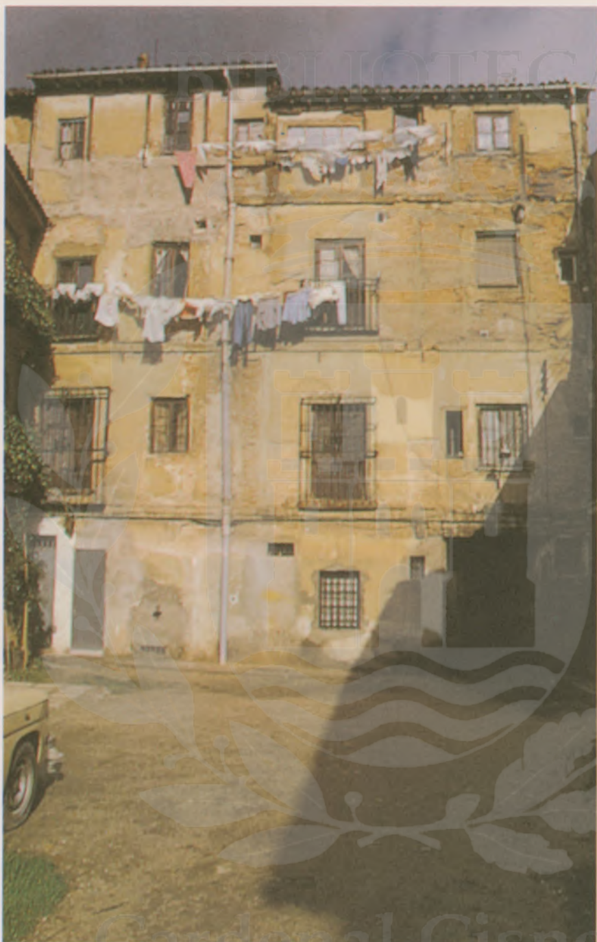
Dentro del programa de renovación de la edificación se ha recuperado el antiguo Corral de la Sinagoga; en la foto aparece el mal estado en que se encontraba.
