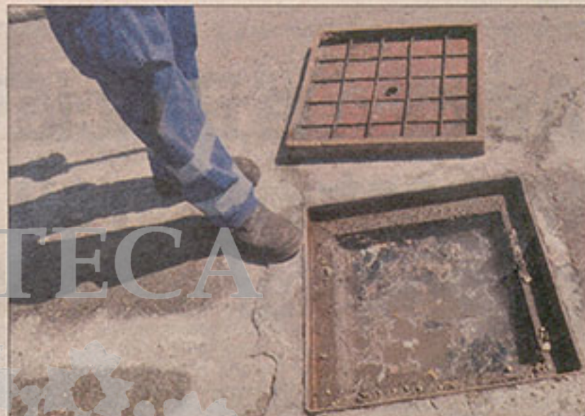
LA PRUEBA. Las alcantarillas de las empresas están atascadas por los restos
