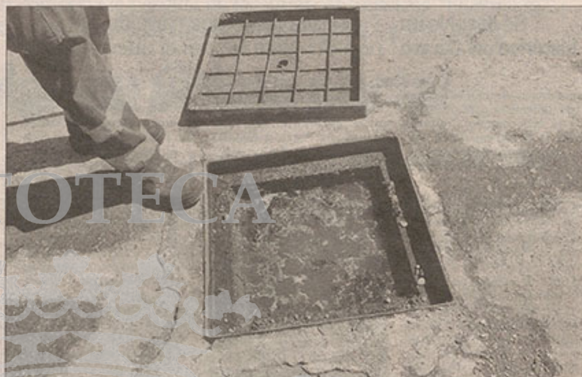
ATASCO. Las alcantarillas de las empresas vecinas rebosan restos de aves tales como sangre y plumas
