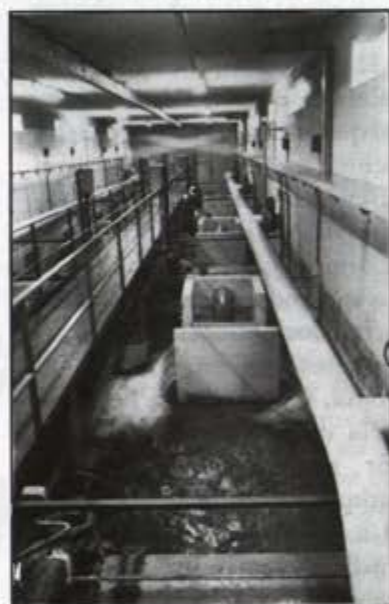
Instalaciones de la planta potabilizadora de Mohernando.
