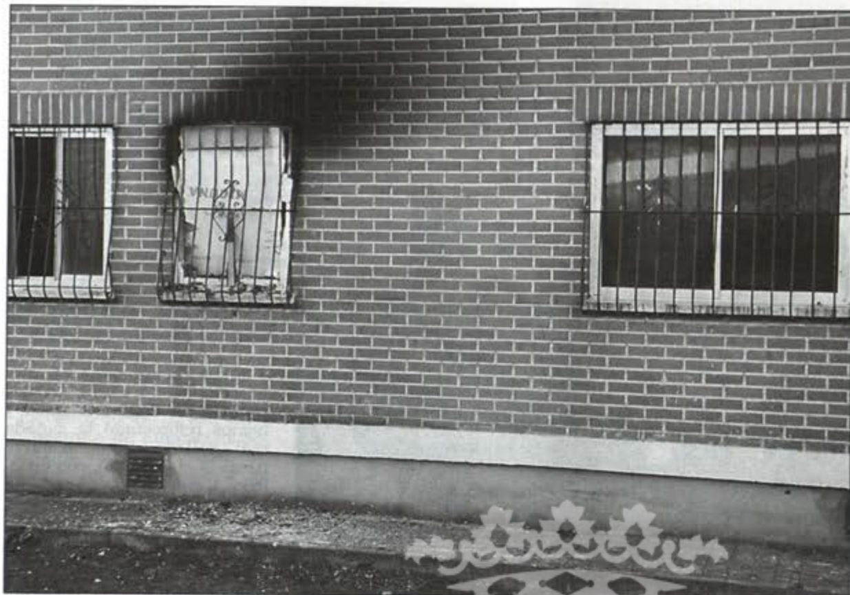
Exterior de la vivienda donde se produjo el fuego.
