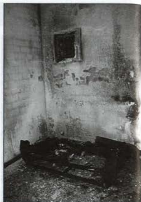
Fue un incendio localizado, sólo se quemaron un registro eléctrico y un sofá. Los problemas los ocasionó el intenso humo.
