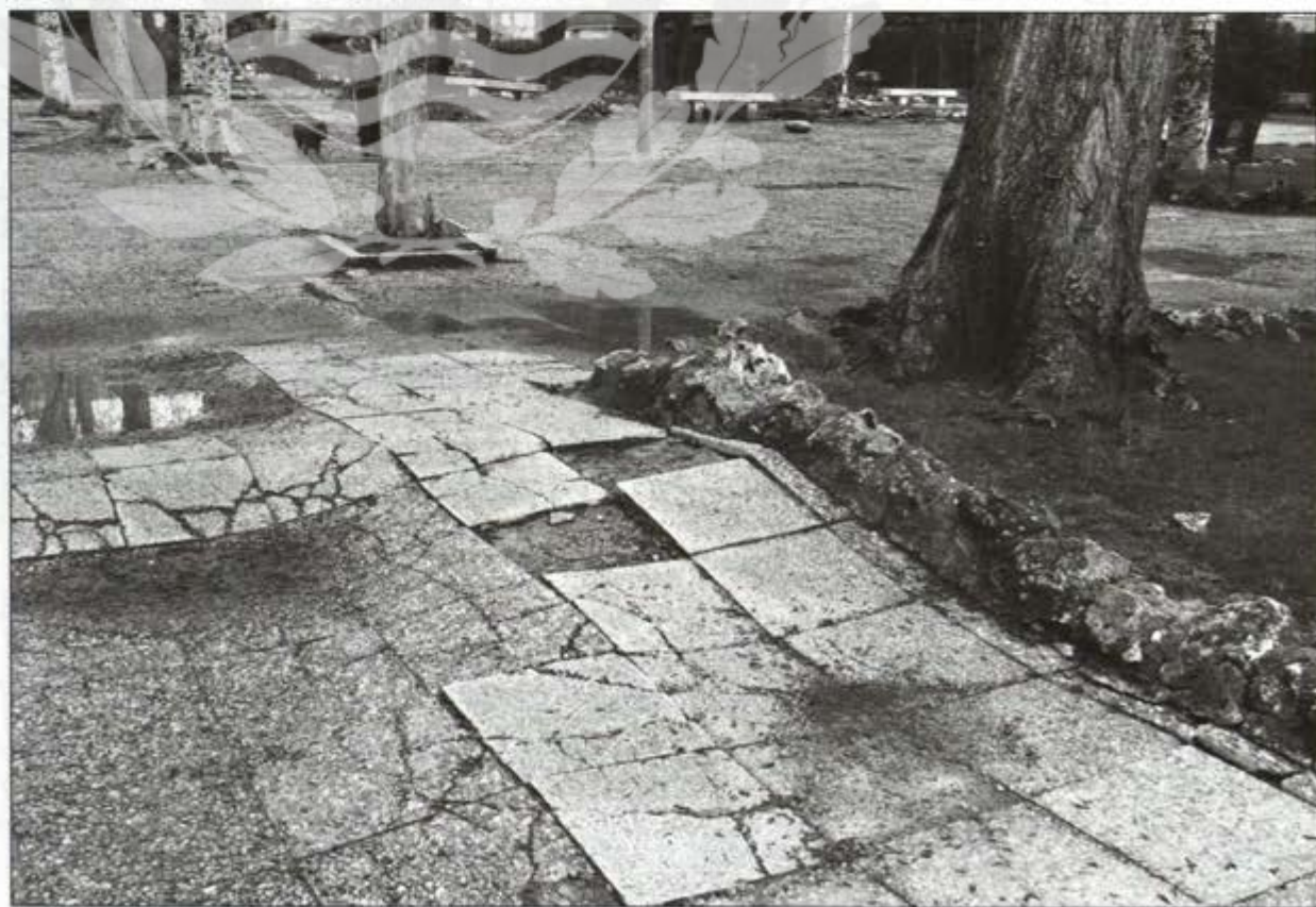
El pavimento del parque de la calle San Vidal está muy deteriorado
