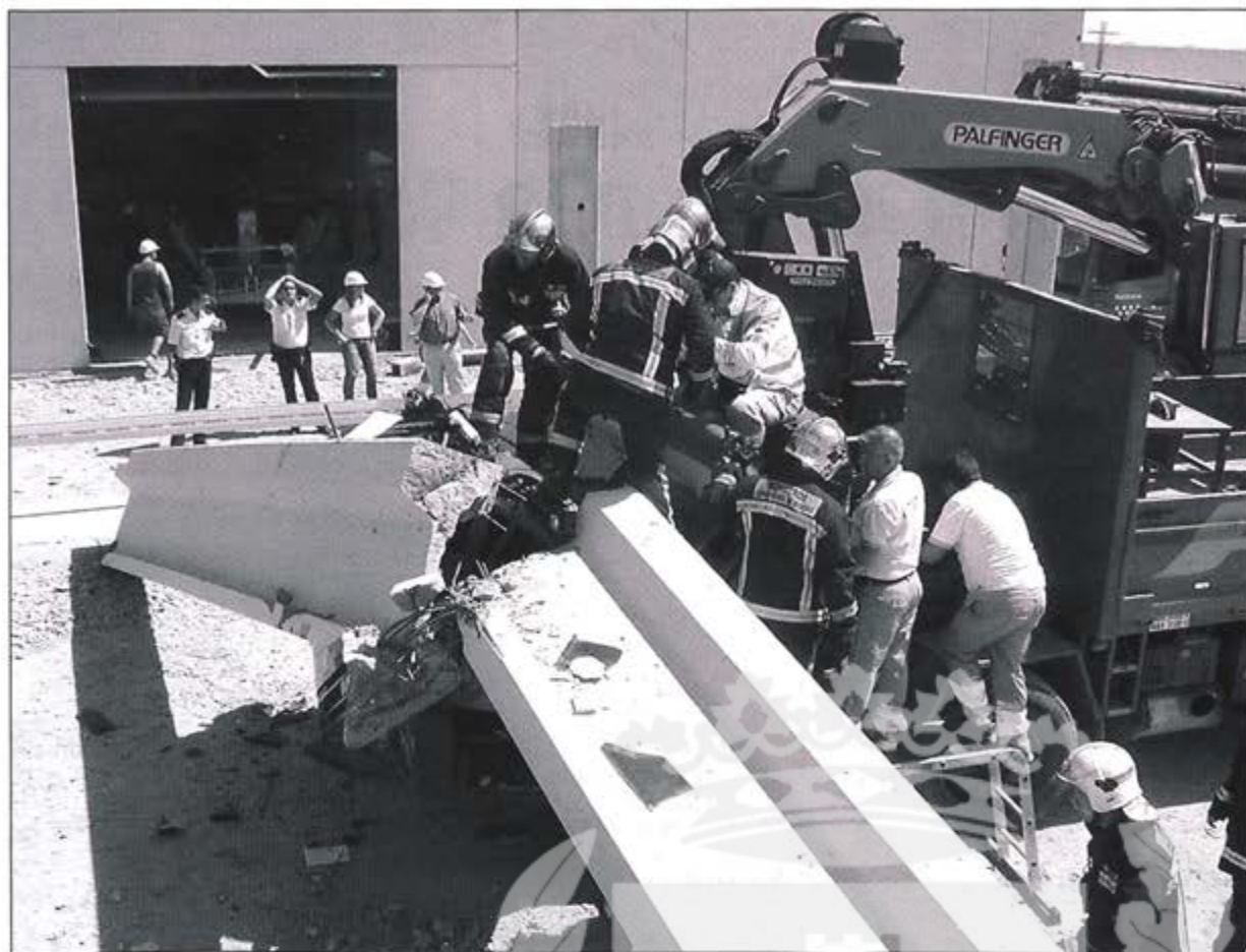
La viga cayó sobre la cabina del camión y atrapó en ella al trabajador, cuyo cadáver tuvo que ser rescatado por los bomberos, como se ve en la fotografía.
