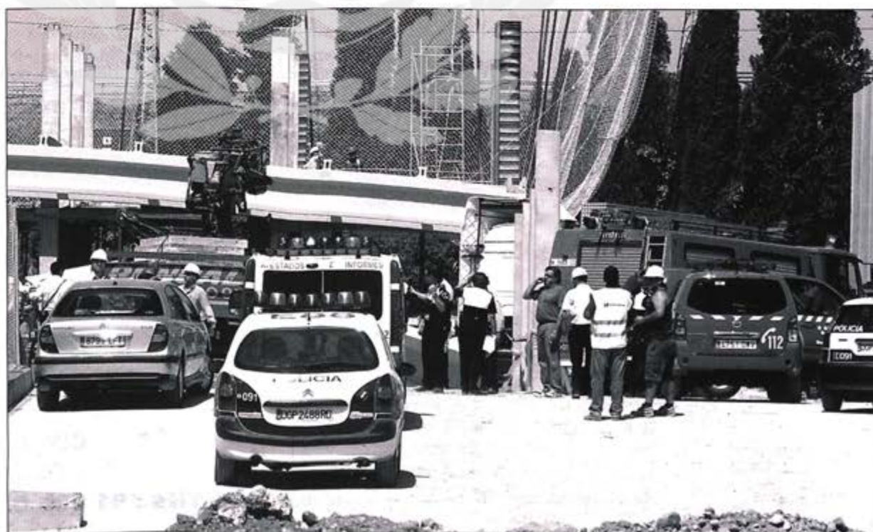
El accidente ocurrió en las obras de construcción de la nueva factoría de POLISEDA.
