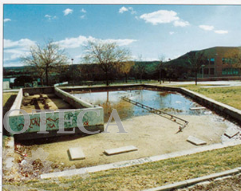
Fuente decorativa de La Garena, sólo con agua de lluvia.
