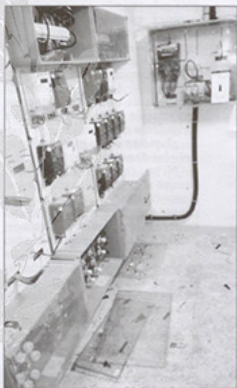
Cuarto de contadores de un bloque de viviendas de la EMV
