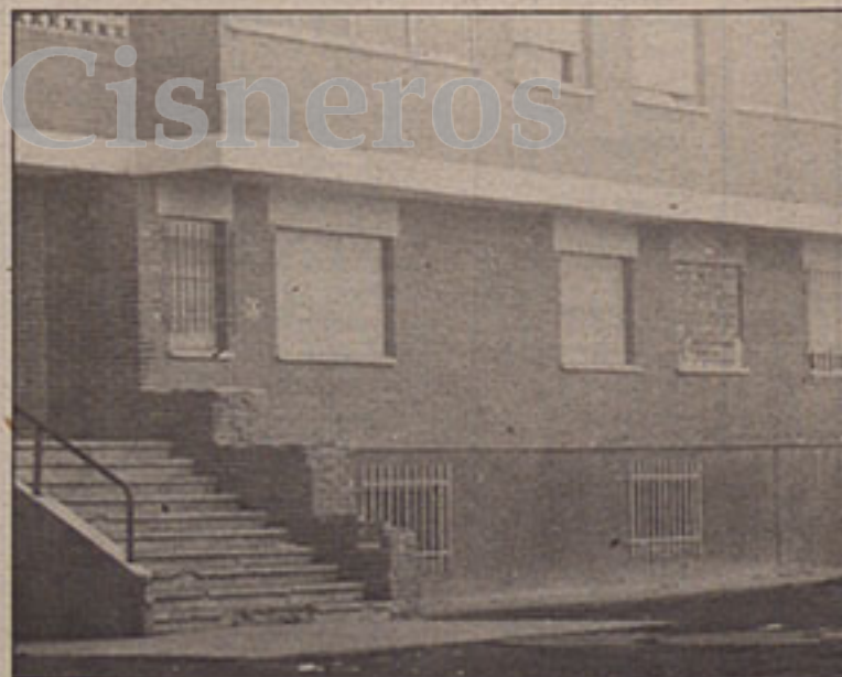
Tras el incendio se tapió la ventana.
