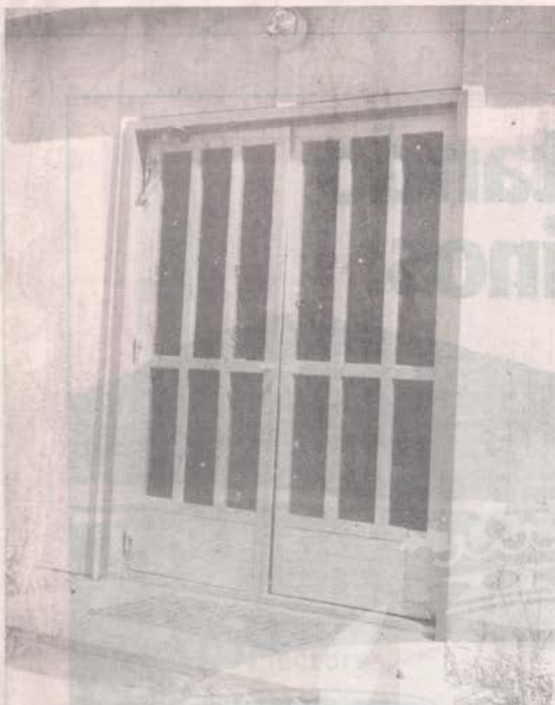
Hace dos meses que esta puerta no puede ser cerrada. Sólo le falta reponerle su cerradura. Pero el ayuntamiento, según dice, no puede hacerlo.
