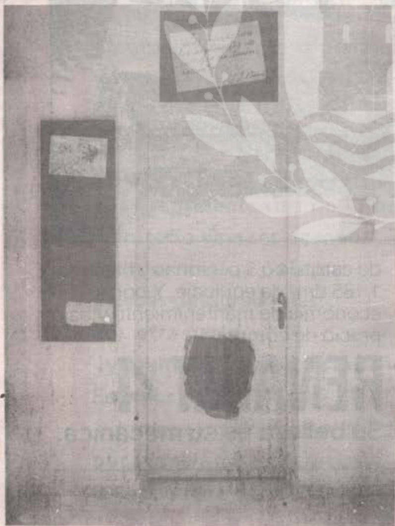
Vergonzoso y persistente estado de una de las puertas. El ayuntamiento, según se repite, tampoco tiene dinero para arreglar o sustituir esta puerta.
