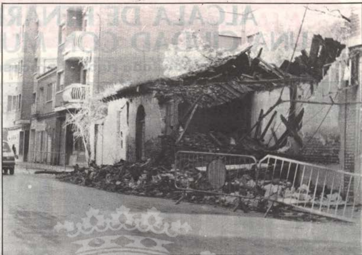
En Nochebuena se cayó esta casa de la calle Cánovas del Castillo. No es la única de la zona del paseo de la Estación y alrededores que se encuentra en un avanzado estado de ruina.
