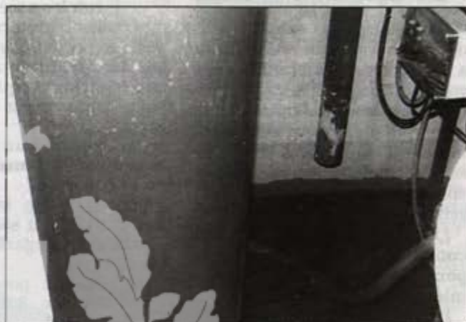
El sistema eléctrico no queda lejos del nivel del agua
