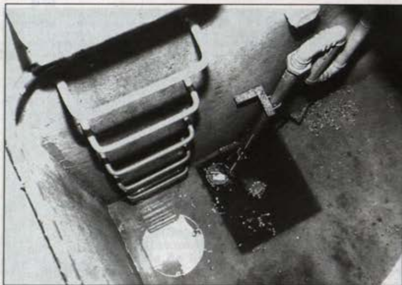
Imagen del interior de los depósitos inundado de agua
