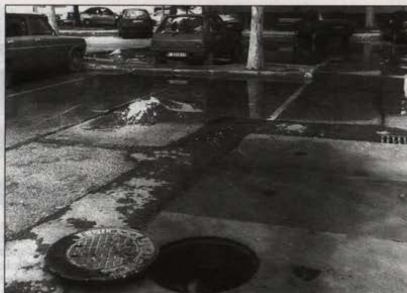
Los charcos están muy cerca de la boca de riego
