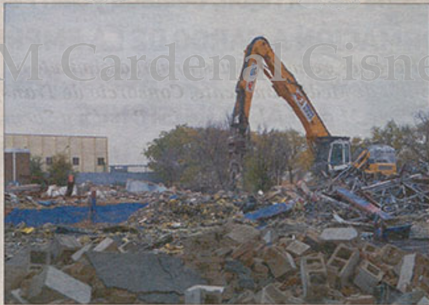
INCENDIO. La nave del polígono Azque ya está convertida en escombros
