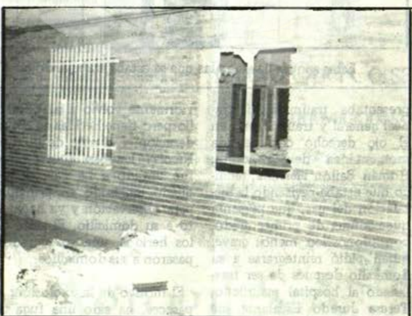
La fuerza de la explosión arrancó rejas y persianas del piso bajo
