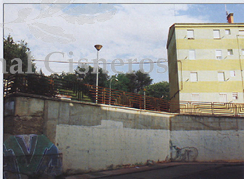
Será reforzado este muro, que se halla detrás de la placita.
