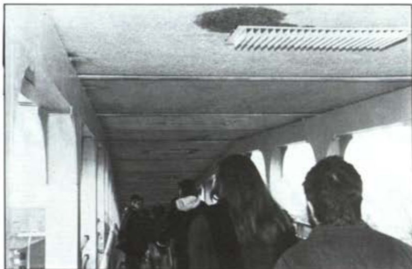
Imagen interior de la pasarela recién construida, en la que se aprecian las goteras y los charcos producidos por las recientes lluvias.
