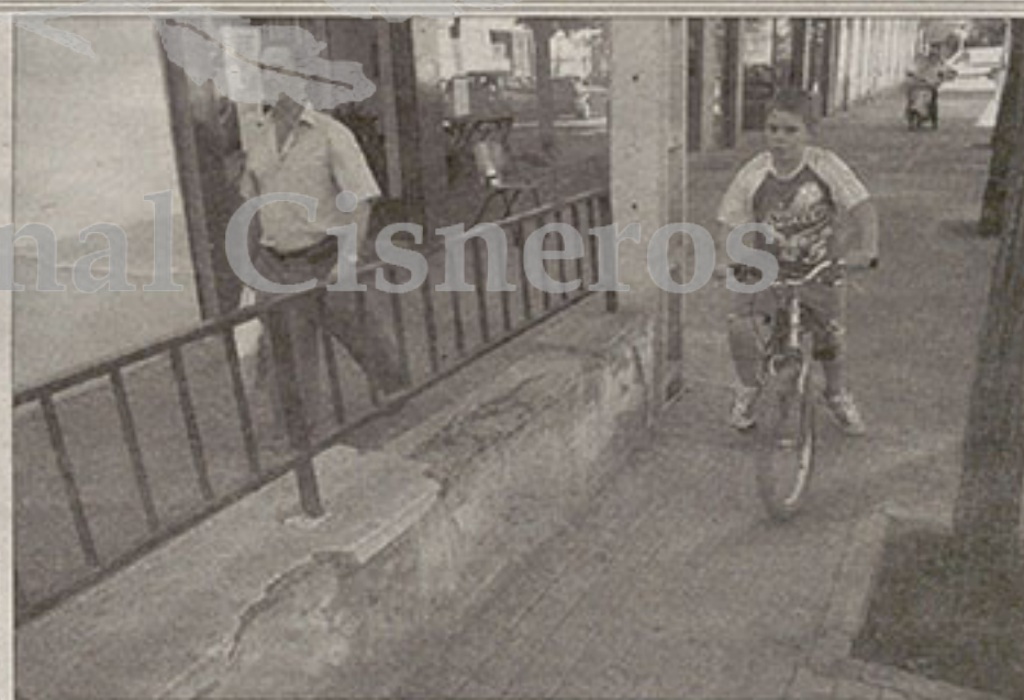
DETERIORO AVANZADO EN GINER DE LOS RÍOS. No es un acto vandálico de fin de semana, sino el deterioro progresivo del mobiliario en Giner de los Ríos, junto a Agudores. Las aceras están levantadas y el poyete de una barandilla -en la imagen- está destrozado. Los vecinos se han quejado de una situación prolongada en el tiempo.
