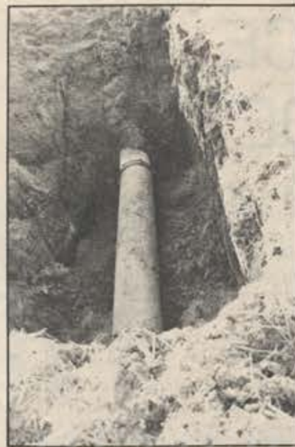
Las averías agudizan sobremanera el problema del abastecimiento. En la foto, el tramo de tubería averiada en la conducción de Humanes, una vez reparada aquella.
