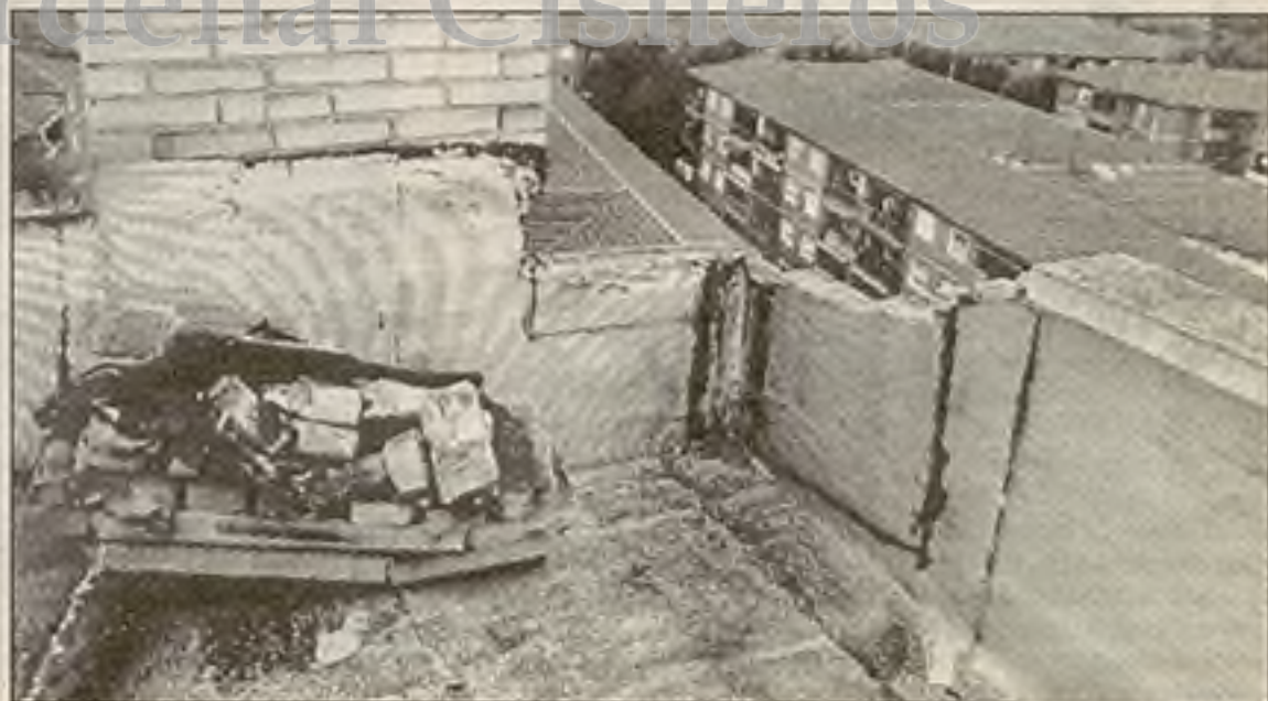
Desperfectos en uno de los edificios
