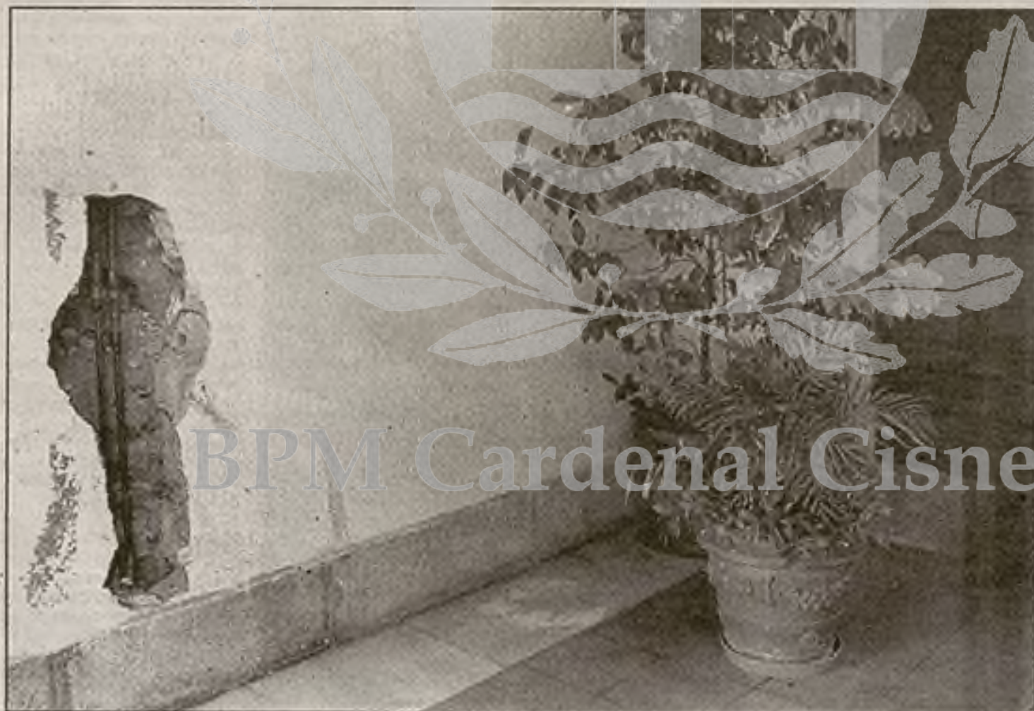
Un agujero en la pared deja al descubierto el entramado de tuberías de la Cisneriana
