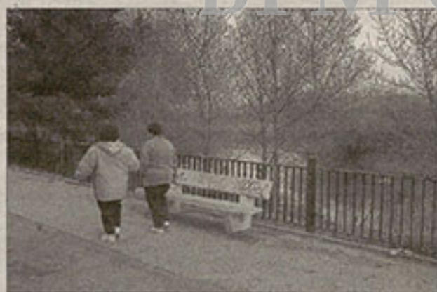
Nueva Alcalá. Es la actuación más urgente. Hay una erosión fluvial que está socavando los taludes de la mota y se aprecian signos claros de hundimiento y roturas. Es prioritario reformarlo con una mayor integración en el paisaje.
