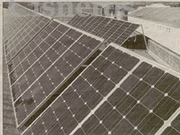
Varios paneles solares en el tejado de una casa
