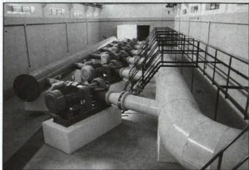
Grupo de presurización
