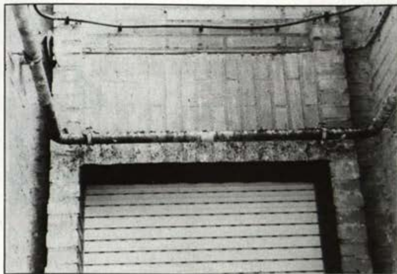
Las heces de paloma se acumulan por cañerías y fachada.
