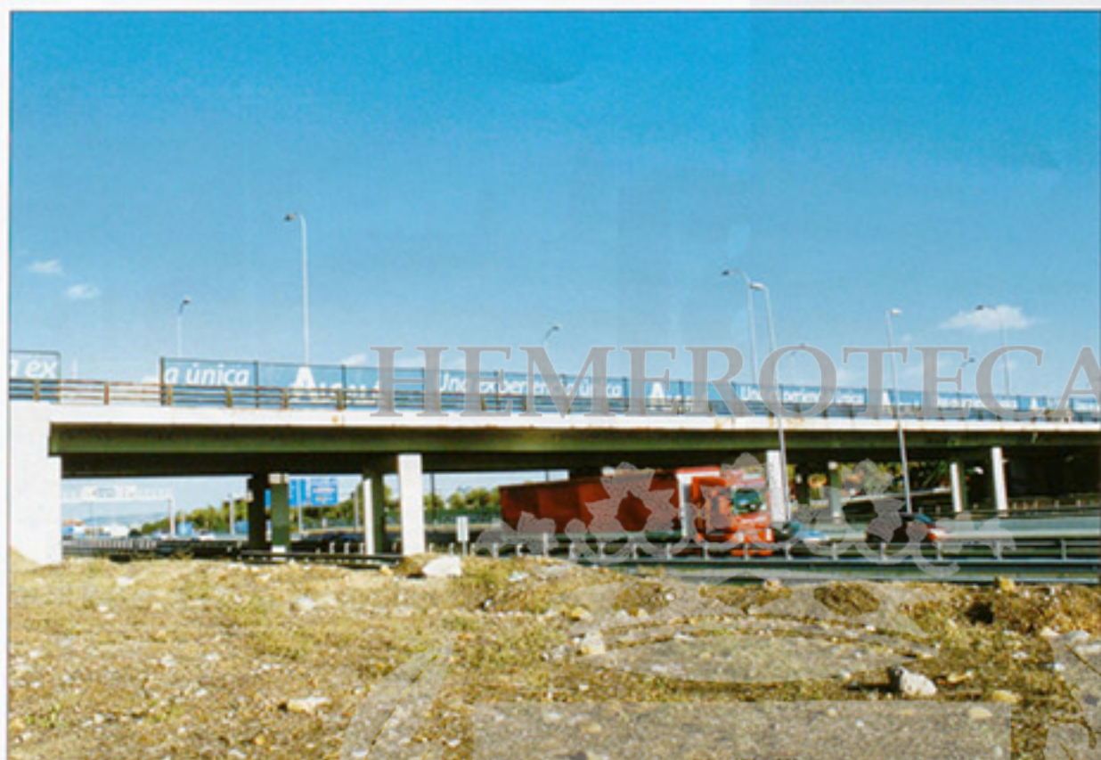
Falta este panel junto a Espartales. A la derecha, panel transparente que suplió al otro caído.
