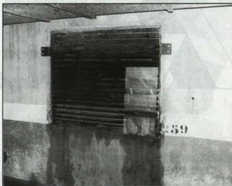
Por esta rejilla se colaba en el aparcamiento de la Vía Complutense el agua de la tormenta que cayó sobre la ciudad el pasado viernes.
