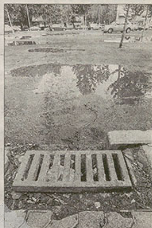
Las alcantarillas no evacuan lo necesario / R.E.
