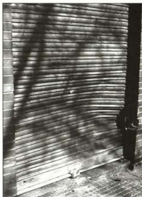
El cierre del establecimiento quedó muy deteriorado, pero aguantó la embestida.
