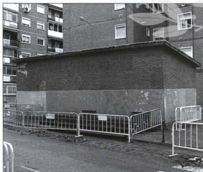
El transformador que está situado en la zona debería de desaparecer, ya que está fuera de lugar
