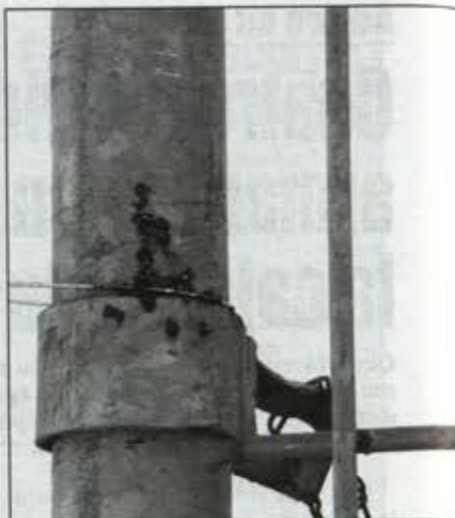
En la valla metálica se registraron anteriormente al incidente algunos chispazos eléctricos como queda reflejado en las marcas de la fotografía
