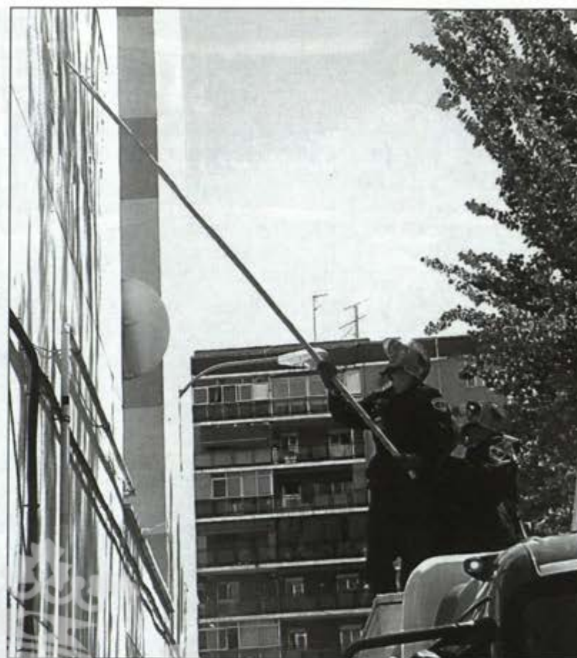
Momento en que los bomberos proceden a retirar los cascotes que amenazaban peligro de desprendimiento
